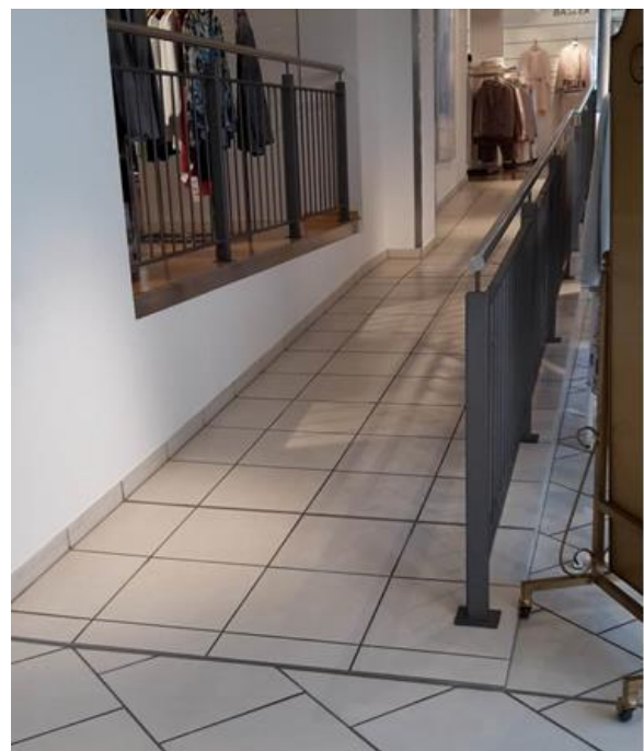
Bild 4: Rampe mit Handläufen und geringer Steigung; nicht rutschhemmend
